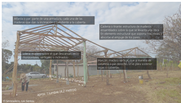
Figura 2: Armadura de par e hilera para una casa de quincha en el Sesteadero, Los Santos (foto de la autora).
