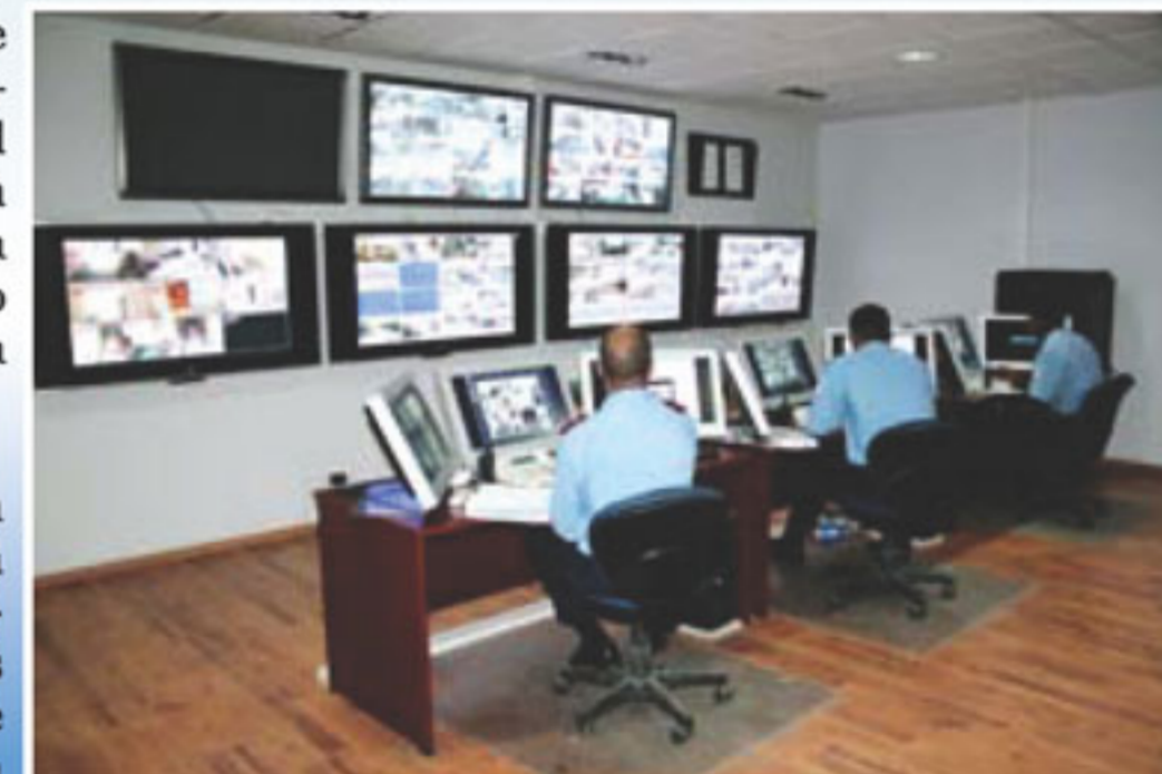
El Centro de Monitoreo es operado por personal de la Zona Libre de Colón que ha sido entrenado para brindar un servicio eficiente.
