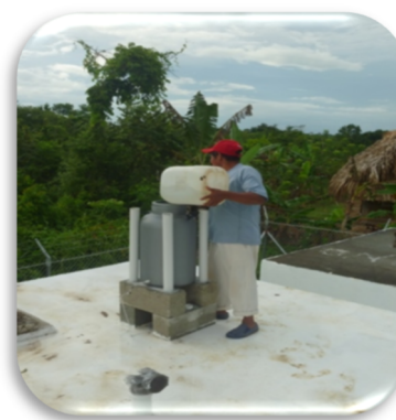
Figura 4. Vaciado de solución de hipoclorito de sodio al tanque dosificador para la desinfección del agua abastecida de la fuente natural en tanque de reserva o de almacenamiento.
