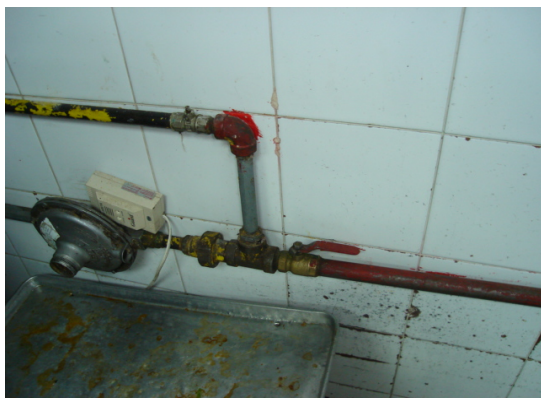
Figura 10. Modificaciones a instalación original.
