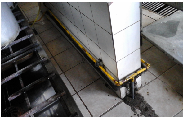
Figura 9. Tubería empotrada de GLP.
