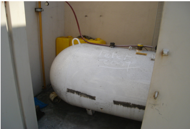
Figura 3. Tanque junto a recipientes de almacenamiento de grasas y combustibles.
