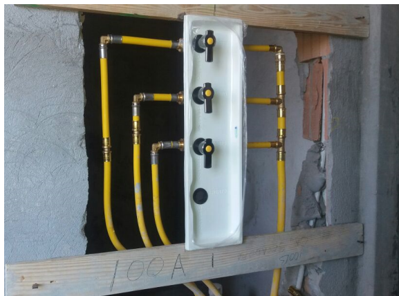
Figura 6. Tubería de P-Al-P instalada al interior de edificios.
