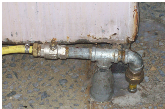
Figura 15. Falencias en instalación de tuberías de conducción de GLP.
