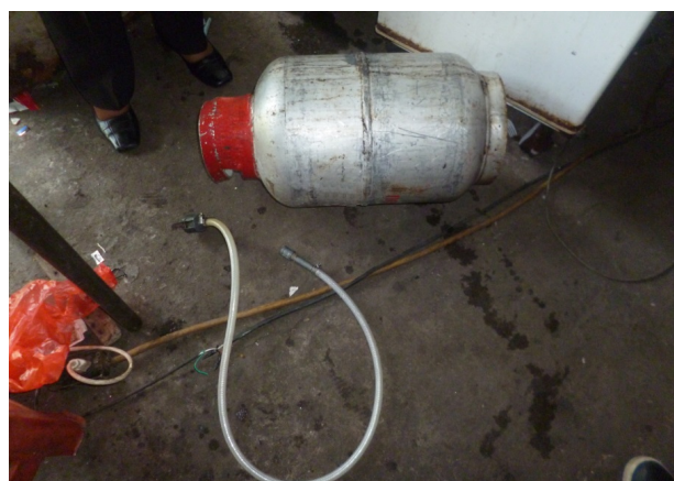
Figura 12. Manguera plástica para agua utilizada en la conexión de aparatos a gas.
