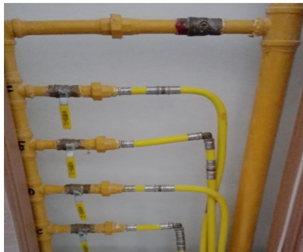
Figura 7. Tubería de P-Al-P instalada al interior de edificios.
