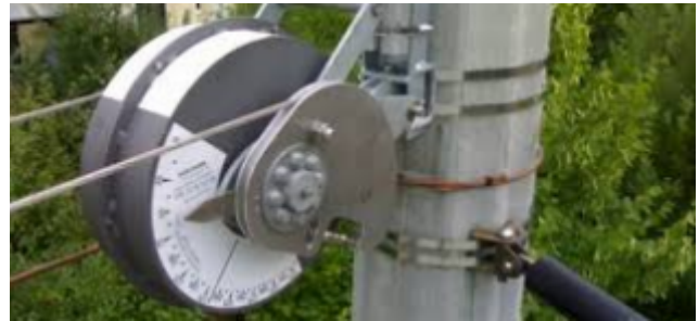
Figura 5. Equipo Tensorex. Ingeniería conceptual Línea 2. Especificaciones funcionales, técnicas y contractuales. Tomo II. Equipamientos [37].
