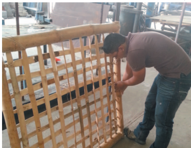
Fabricación de Paneles de adobe reforzado con bambú (sistema de casas de quincha)
