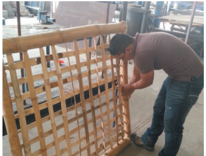
Fabricación de Paneles de adobe reforzado con bambú (sistema de casas de quincha)
