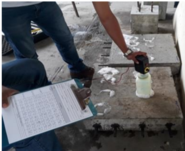
Figura 2. Medición del potencial de corrosión sobre las losas
