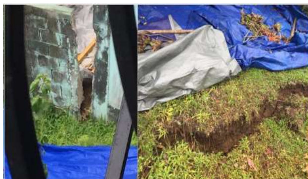
Figura 1. Casas con deslizamiento de tierra.
