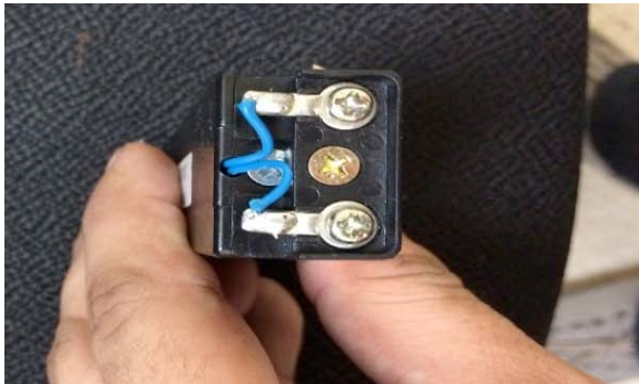
Figura 10. Vista de terminales de cerradura electrónica.
