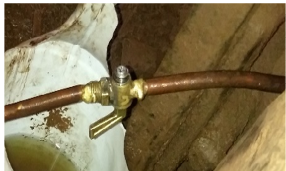
Figura 2. Válvula colocada para regular la cantidad de diésel aplicado.
