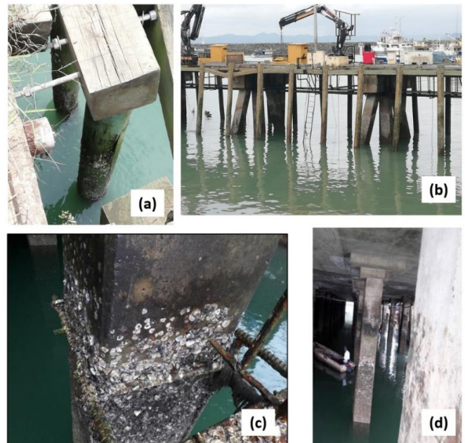
Figura 2. Diversos daños a pilotes en Puerto Vacamonte. (a) y (b) daños en pilotes de madera debido a cargas de impacto. (c) y (d) invasión de agentes biológicos en pilotes de concreto.
