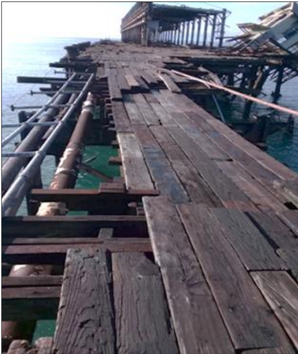
Figura 1. Daños causados por actividad sísmica al Muelle Fiscal de Puerto Armuelles, Provincia de Chiriquí, República de Panamá. Fuente: Autoridad Marítima de Panamá (2019) [3].
