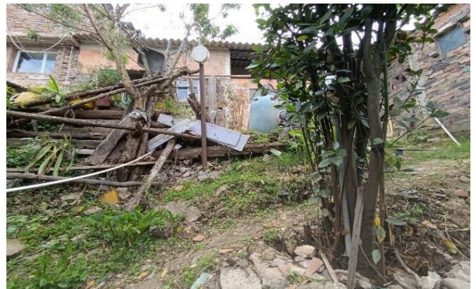
Figura 3. Casalote con riesgo de deslizamiento.
