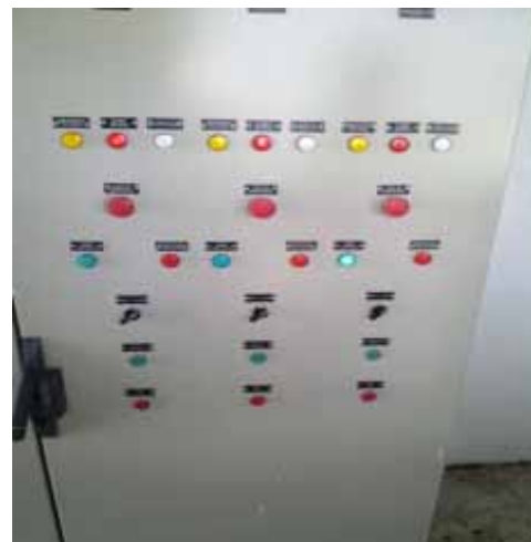
Figura 6. Panel de control de bombas.
