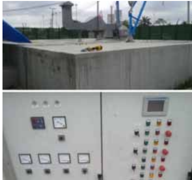
Figura 5. Cámara de conducción y Panel de control de bombas.
