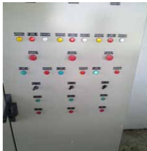
Figura 6. Panel de control de bombas.
